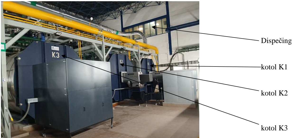
Obrázok č. 1 Pohľad na kotly a označenie kotlov K1, K2 a K3
